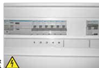
Intérieur du coffret électrique triphasé
