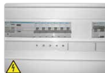
Intérieur du coffret électrique triphasé
