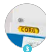
Fenêtre de contrôle de présence du filtre
